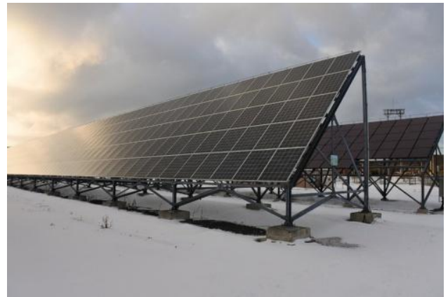
(稚内太陽光発電所)
